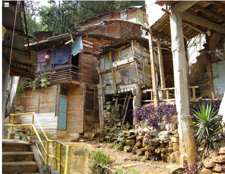
Imagen 63: Vivienda del sector Juan Bobo antes de la ejecución del proyecto Fuente: EDU, 2005.
