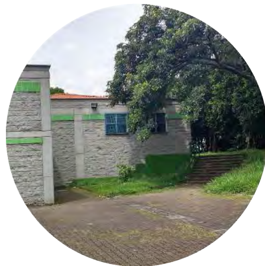
Figura 276 ▲ Estado actual costados Coliseo Carlos Mauro Hoyos Fuente: fotografía Archivo urbam EAFIT, 2017
