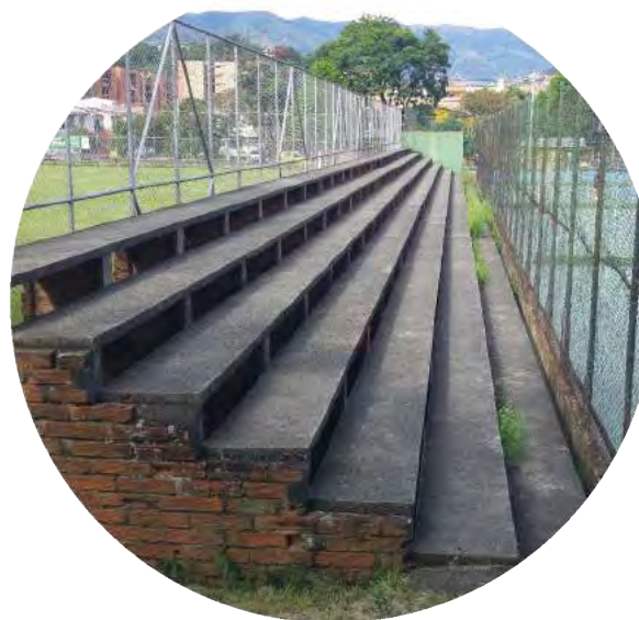
Figura 249 ▲ Gradería canchas de tenis Unidad Deportiva de Belén Fuente: fotografía Archivo urbam EAFIT, 2017
